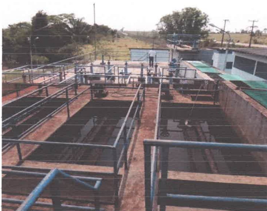
Figura 5.6: Vista dos Filtros da ETA.
